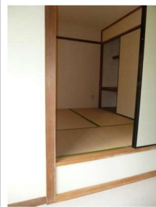
4畳半和室への出入口の段差が40cm
